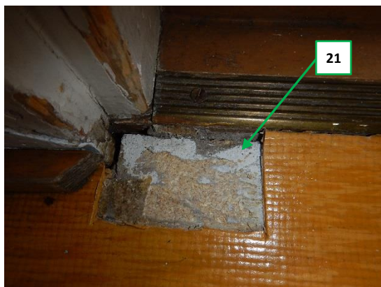
Kuva 80. Näyte 21 lattian muovimatto + liimaa ja tasoitetta 1. krs lattiasta.
