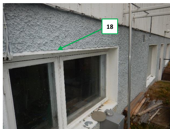
Kuva 77. Näytteen 18 ottokohta takasivulla. Näytteessä rappauksen lisäksi valkoista ja siniharmaata maalia.
