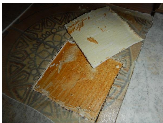
Kuva 7. Olohuoneen lattia, avauskohta AP4. Muovimatoissa erittäin voimakas haju.
