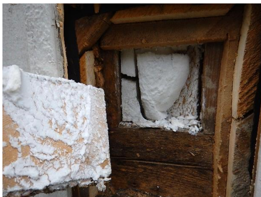
Kuva 31. Rakenneavauspaikka US3, purut on korvattu ureavaahdolla, vaahtokerros ei ole tiivis.
