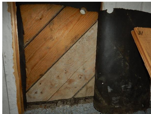
Kuva 22. Rakenneavaus US1, vinolaudoituksen alareunassa kastumisen jälkiä. Tervepaperissa ki-vihiilitervan hajua.
