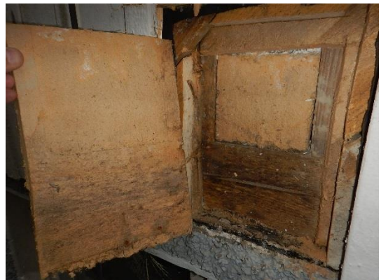
Kuva 30. Rakenneavaus US3, puukuitulevyssä pilkkumaista kasvustoa alareunassa.
