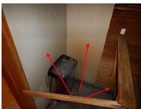
Kuva 58. Asbestisementtilevyt saunan seinissä ja "sokkelissa".
