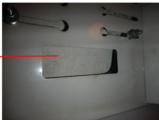
Kuva 54. Lähikuva edellisestä, asbestilevy taustalla.
