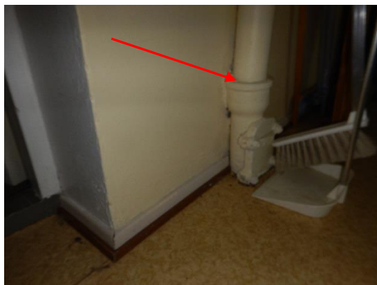
Kuva 60. Valurautaviemäri askarteluhuoneessa. Muhviitoksessa lyijyjuotos, mahdollisesti myös asbestinarua käytetty.
