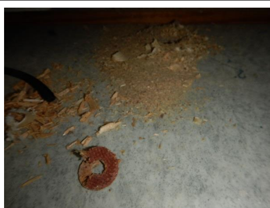
Kuva 44. Rakenneavaus VP4. Uudemman muovimaton alla vanha matto, eristeenä kutterinlastua ja sahanpurua, vahva viite vauriosta
