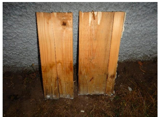
Kuva 28. Rakenneavaus US3, ulkoverhouslautojen alaosissa kosteusvaurioita
