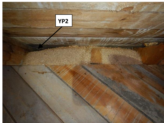
Kuva 47. Yläpohjan tarkastelu paikka YP2. Purut paikoin kiinni katon laudoituksessa.
