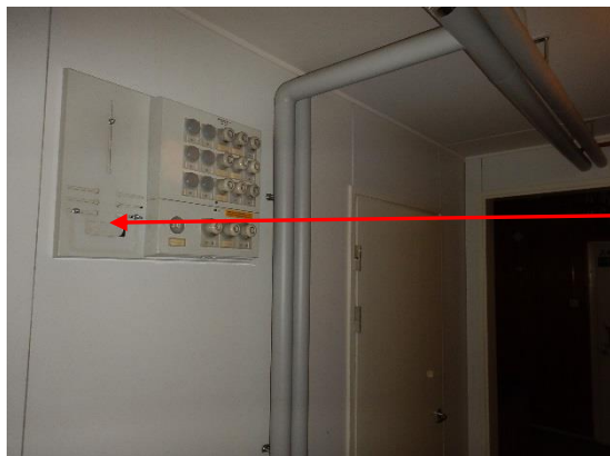
Kuva 53. Sähkökeskus ullakkokerroksen eteisaulassa.
