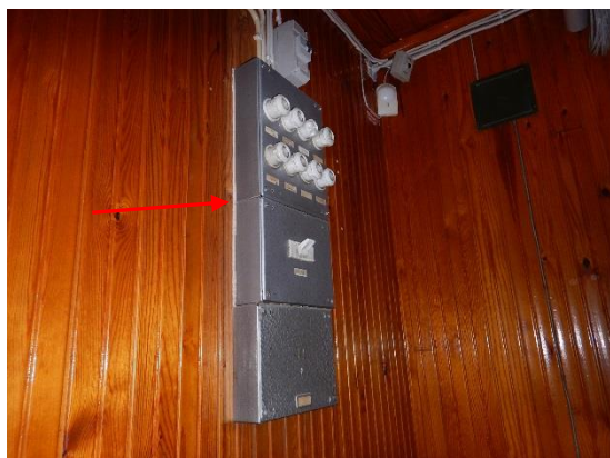
Kuva 55. Sähkökeskus porraskäytävän seinällä, vaalea asbestilevy taustalla.
