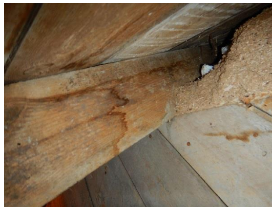
Kuva 48. Lähikuva näytteenottokohdasta, puun seassa ureavaahtoa, vuotojälkiä kattokannattajassa. Näytteessä vahva viite vauriosta.
