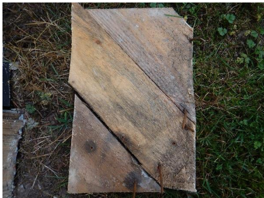
Kuva 29. Rakenneavauspaikka US3, vinolaudoituksen alareunassa kosteusvaurioita.
