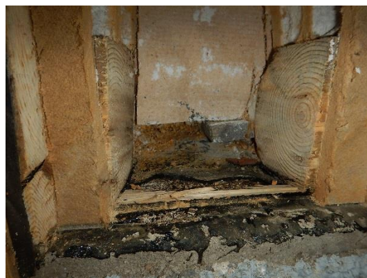
Kuva 24. Rakenneavaus US1, alajuoksu katkais-tuna. Purueristeet on korvattu ureavaahdolla.
