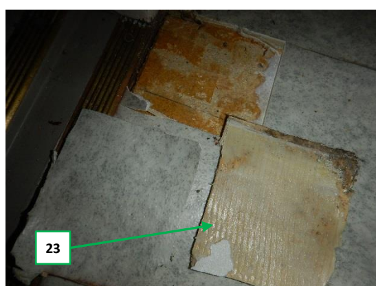
Kuva 82. Näyte 23 ullakkokerroksen asunnon muovimatto + liima uudemman maton alta.
