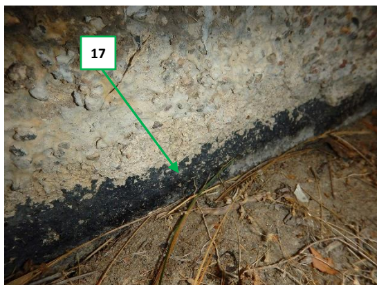
Kuva 76. Sokkelin ulkopinnassa on bitumisively, näyte 17 takasivulta.
