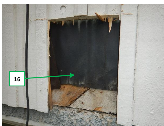
Kuva 75. Tervapaperi julkisivuverhouksen alla, näyte 16. Ei asbestia, mutta korkeat PAH-pitoisuu- det (kts. kohta 6).
