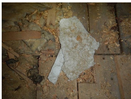
Kuva 56. Asbestilevyn paloja ullakolla, samanlaista kuin sähkökeskusten taustoissa.
