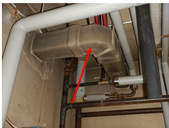
Kuva 51. Asbestisementtiputki kattilahuoneen katossa.
