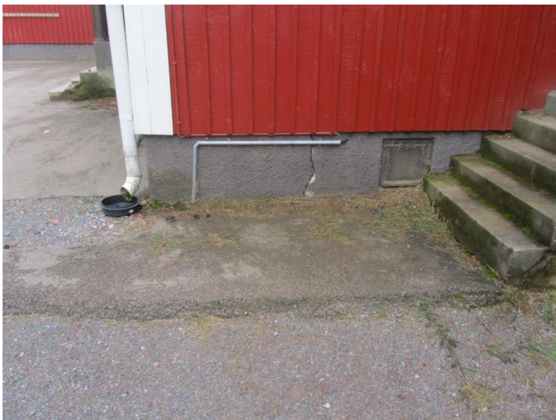
Vanhanosan keittiön päädyssä halkeama.
