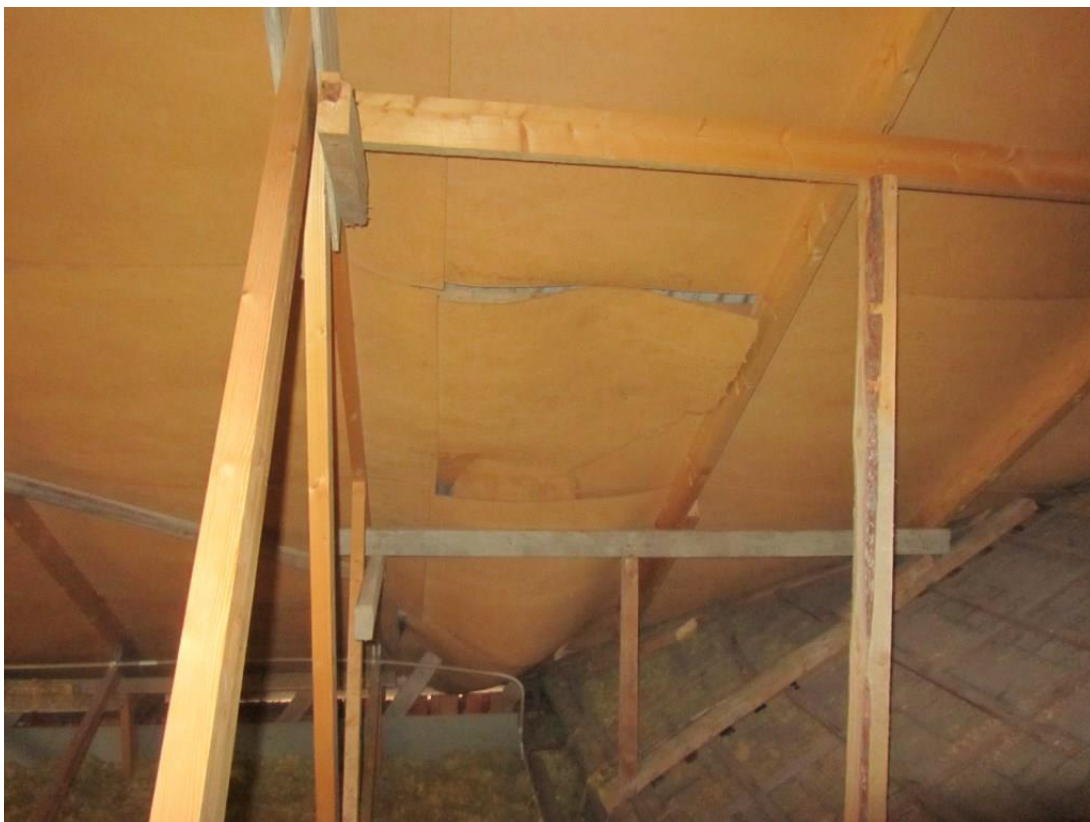
Laajennusosan aluskate kovalevyä, kovalevy roikkuu paikoitellen.
