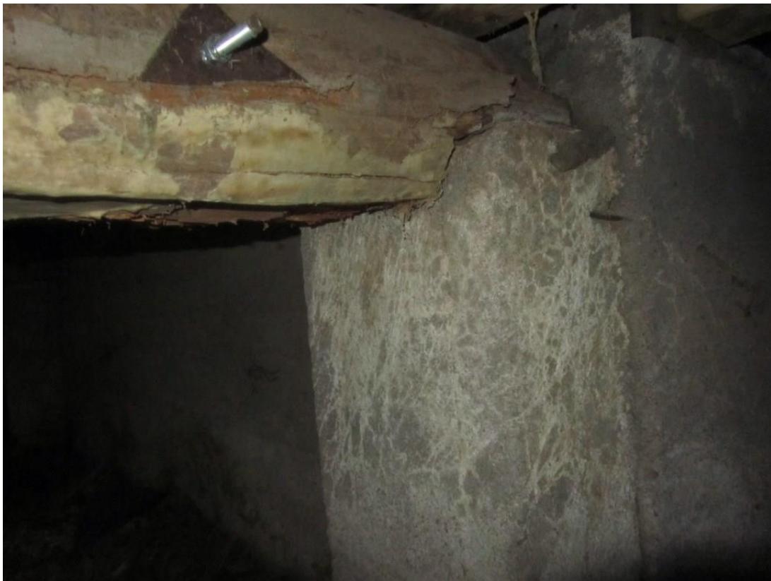
Kasvustoa ja vaurioituneita kannatinpalkkia.
