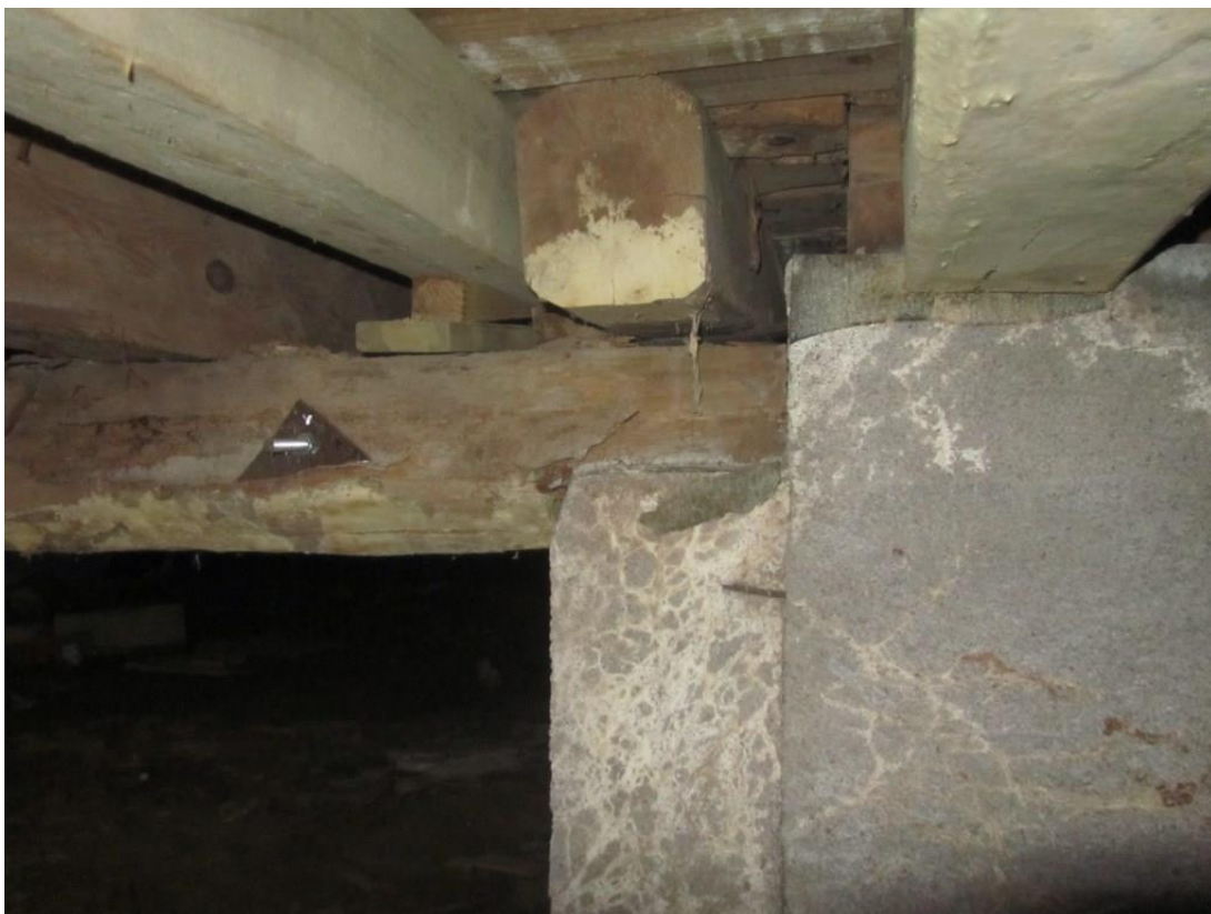
Alapohjatilassa kasvustoa => poistaminen ja desinfiointi homepurkutyöohjeiden mukaan
