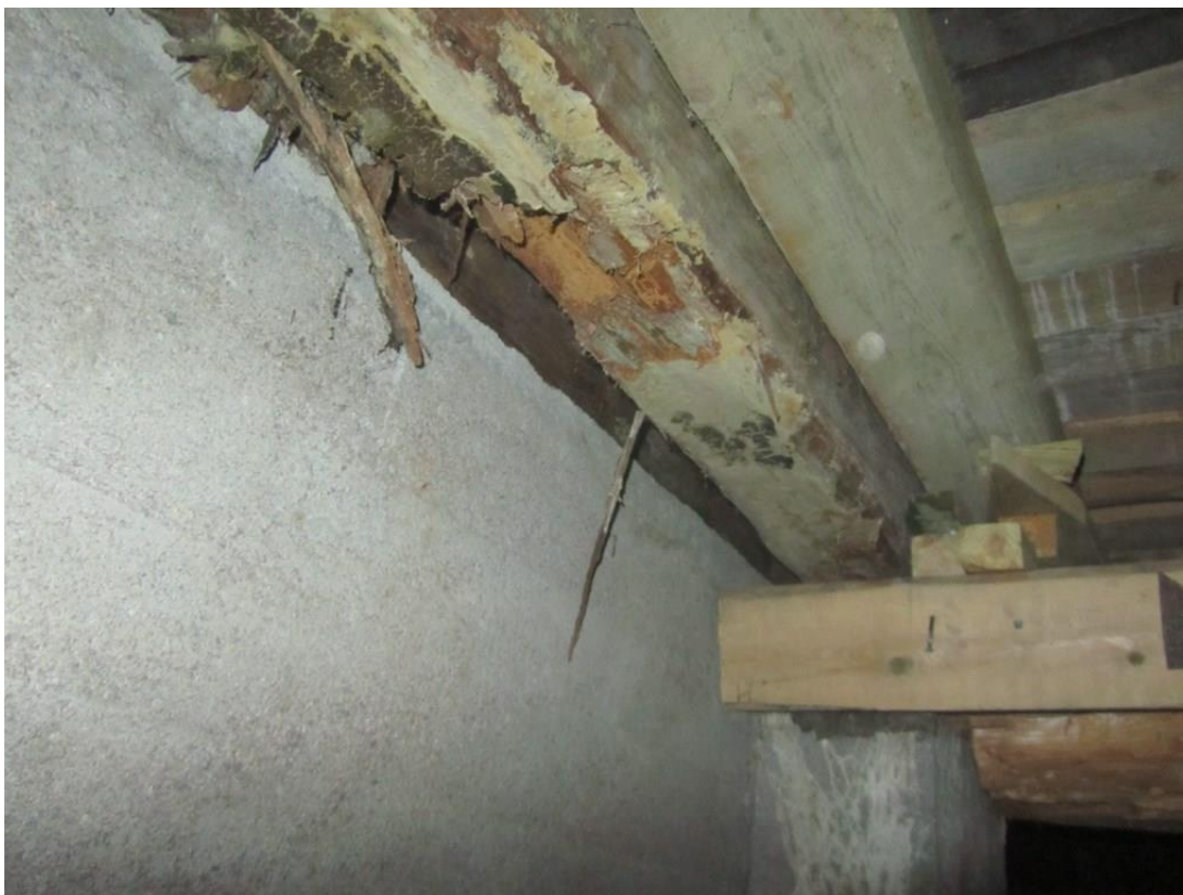
Kasvustoa ja vaurioituneita kannatinpalkkia.
