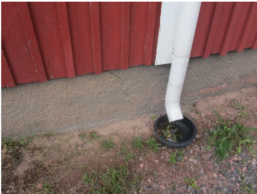
Syöksytorvien alla on rännikaivot, vanhan osan ja laajennusosan liitoskohdassa halkeama.
