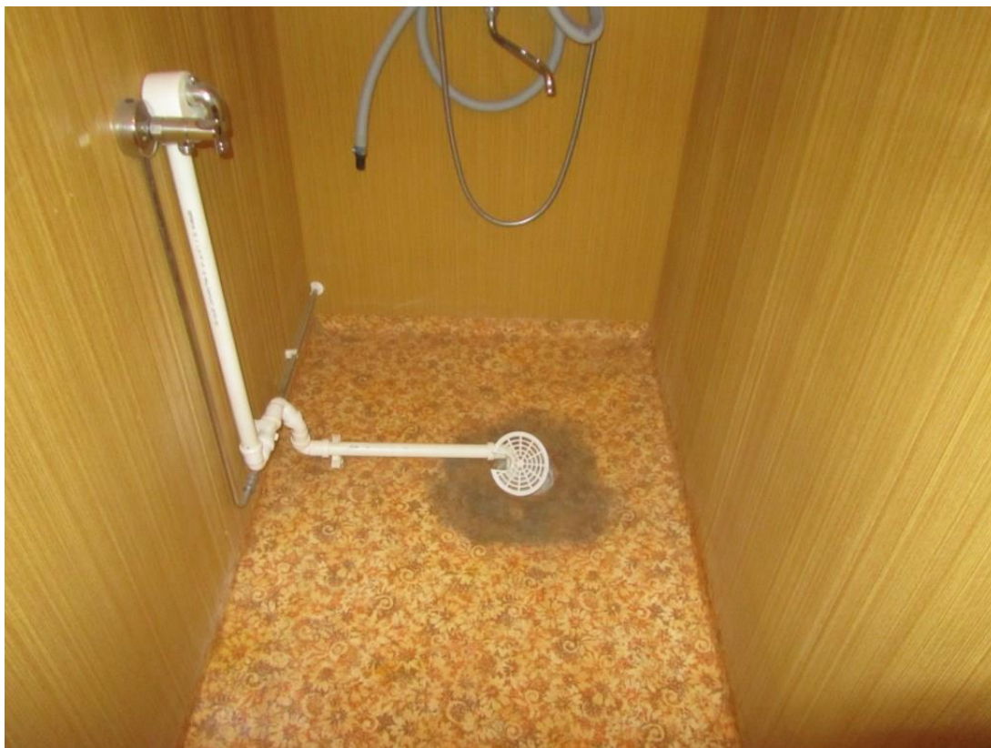
Yläkerran pesuhuoneen lattiakaivon ympärillä muovimatto irti.
