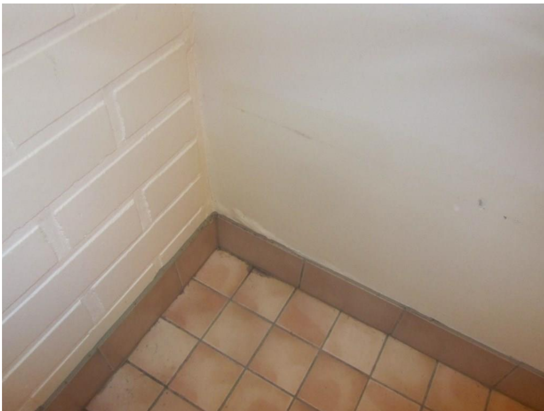
Maalipintojen hilseilyä seinien alaosissa.
