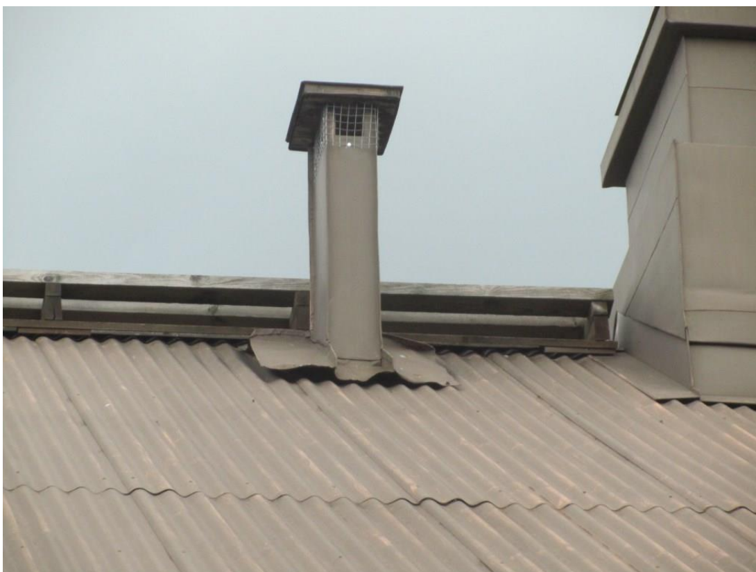
Läpiviennin pellitys vajaa.
