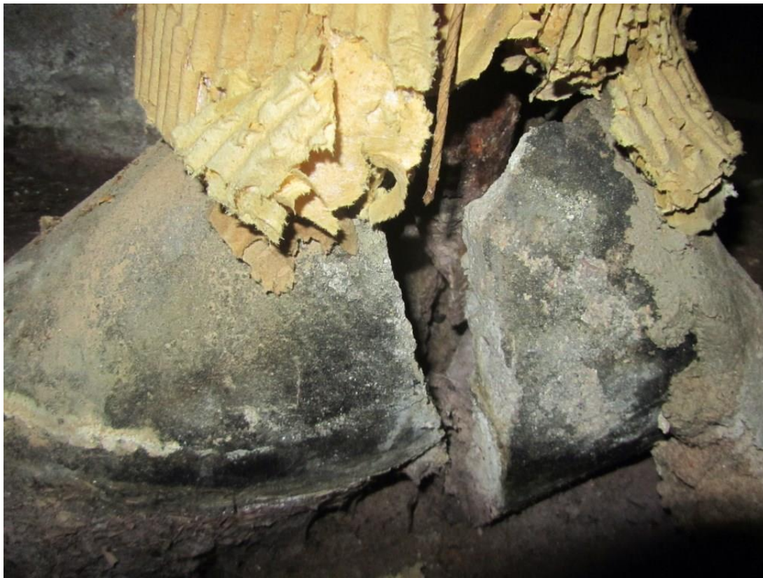
Siivouskomeron viemäröinti liitetty betoniviemäriin, betoniviemäri rikki.
