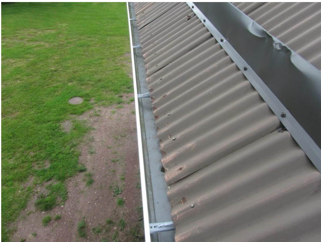
Pellitys nauloilla kiinni, paikallisia korroosioaurioita katteessa.
