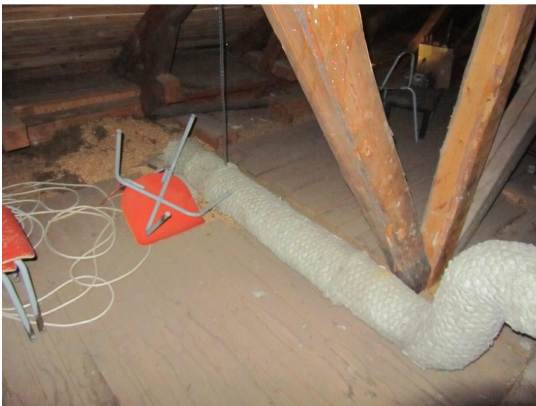
Ilmanvaihtoputket on eristetty hyvin yläpohjatilassa.
