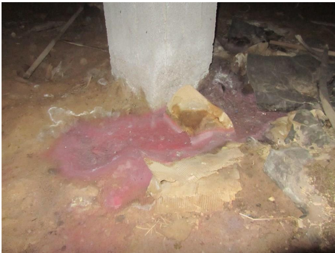
Edellisen kuvan viemärivuotoja alapohjatilaan.
