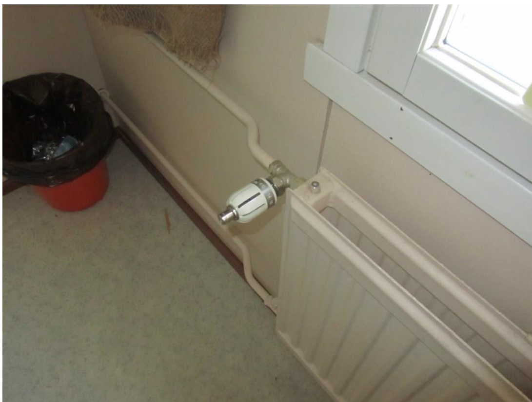
Termostaatteja uusittu jossain vaiheessa
