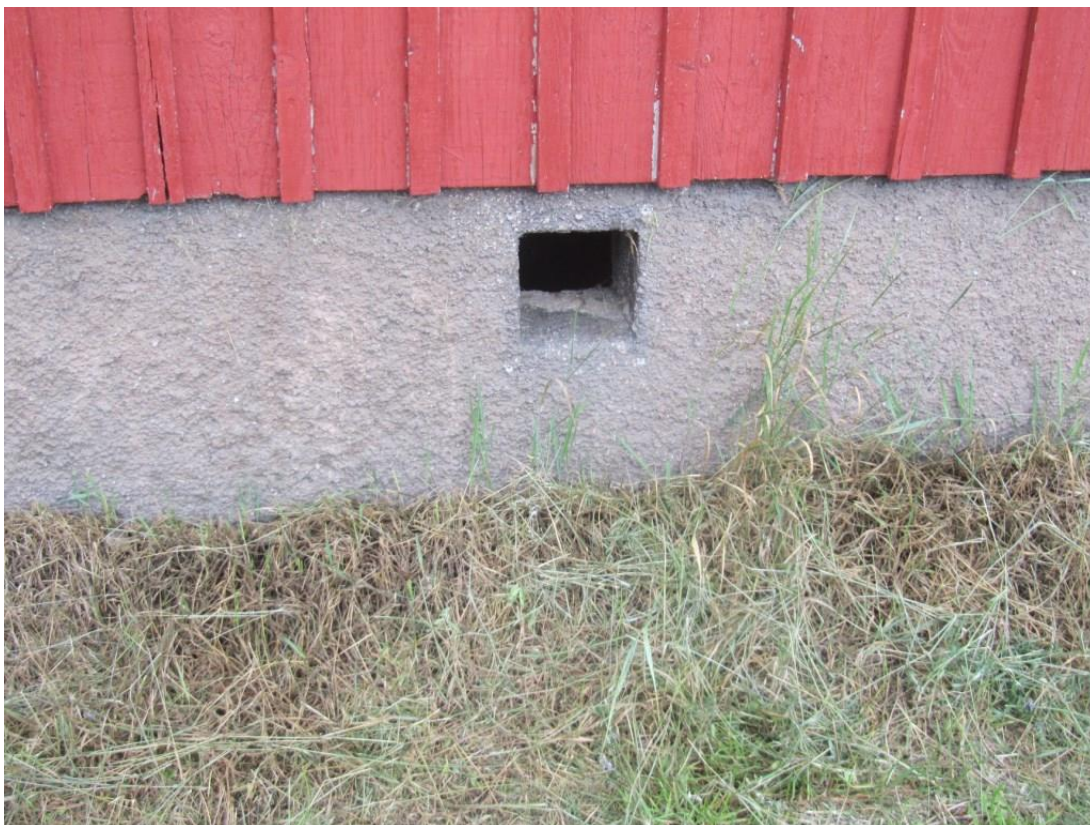
Alapohjan tuuletusaukoissa ei ole pieneläinverkkoja.
