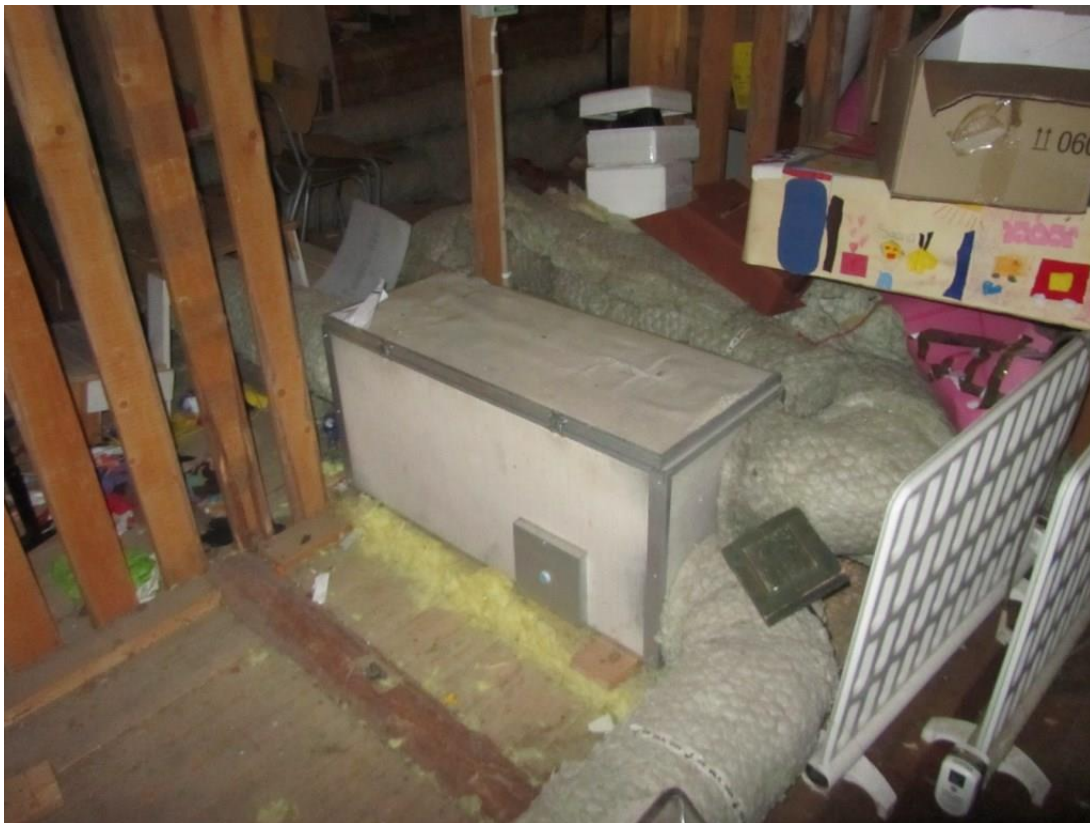
Vanhan osan ilmanvaihtokone
