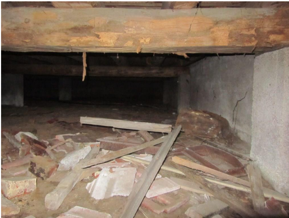
Alapohjatilassa mm. orgaanisia materiaaleja jotka tulisi poistaa.
