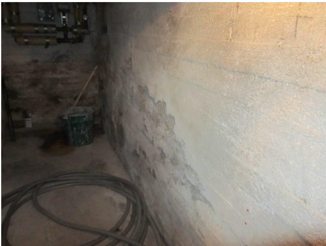
Kellarin seinissä maakosteutta/vauriojälkiä.
