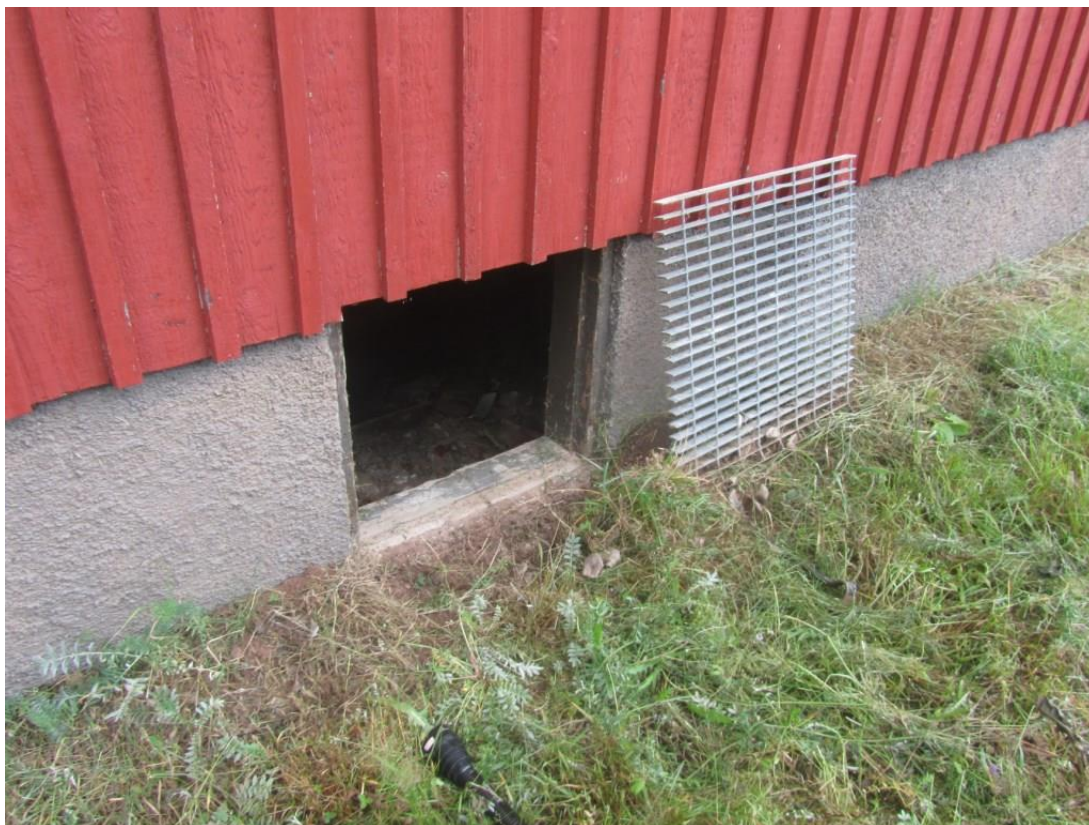
Alapohjan tarkastusluukku jossa teräsritilä.
