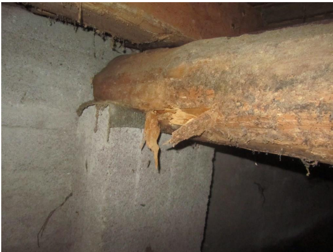
Kannatinhirsissä paikoittaisia lahovaurioita.
