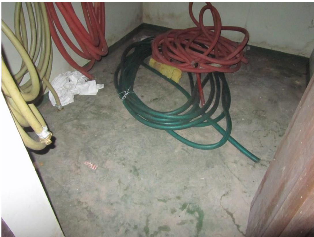
Letkuvarastossa muovimatto ylösnostoin seinissä levy (kellaritila)
